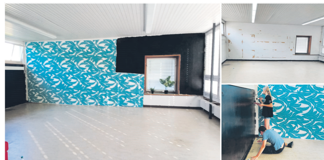
Vor, während und nach der eigenhändigen Umbauarbeiten von insgesamt 53 Stunden von Maria von Allmen, Leiterin Jugendarbeit am Sonnenberg, mit sieben Jugendlichen, die tatkräftig unterstützt haben. Schauen Sie sich das gesamte Endergebnis an der Eröffnung an.
